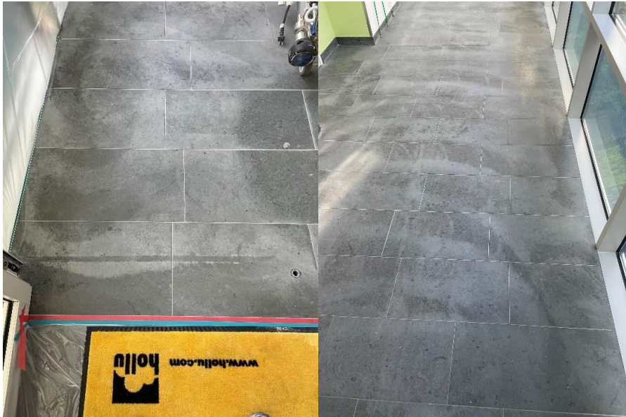
Säureschäden auf Kalkstein:
