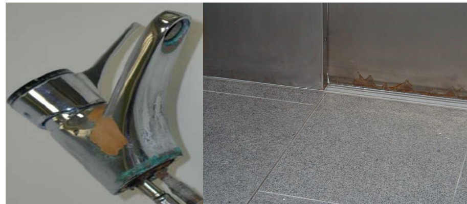
Säureschäden auf Legierungen:
